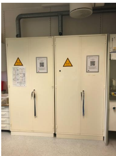
God merking på ventilere avtrekkskap, med QR kode til innhold, klassifisering av kjemikalier og faremerking.
